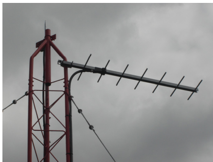
FIGURA 18.- Antena receptora de la información de los niveles del agua
